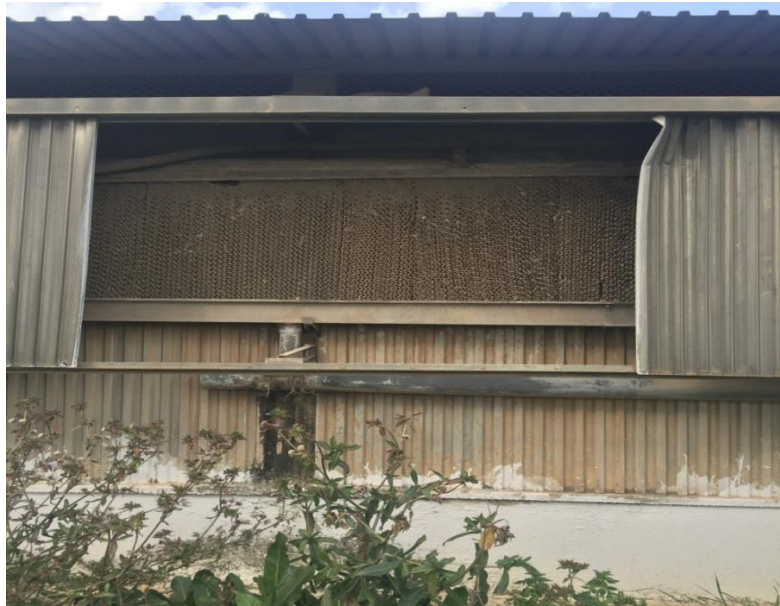
Figure 9 : Système de refroidissement du bâtiment (pad cooling), (photo personnelle, 2015)
