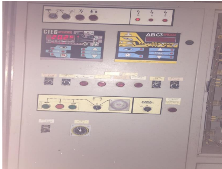
Figure 8 : Armoire de commande du bâtiment d'élevage (photo personnelle, 2015)
