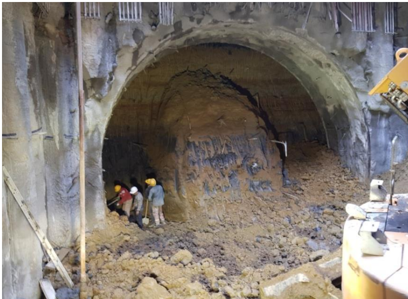
Figure I.8 : Préparation de la mise en place des cintres métalliques après l'excavation (photo prise le 25 février 2019 par les auteurs).
