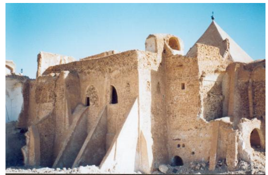
Fig. 3.37 : Vue sur la partie démolie (Ouest) de la Zaouia Tidjania de Guemar (2004). Photo de l'auteur
