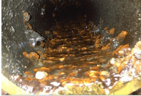
Figure I.4 : Images internes des pipelines (incrustés par des produits de corrosion).
