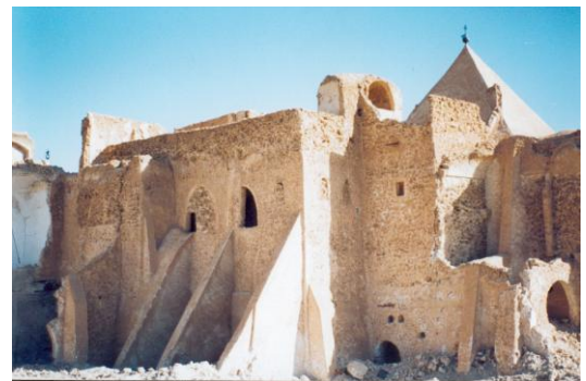
Fig. 3.37 : Vue sur la partie démolie (Ouest) de la Zaouia Tidjania de Guemar (2004). Photo de l'auteur
