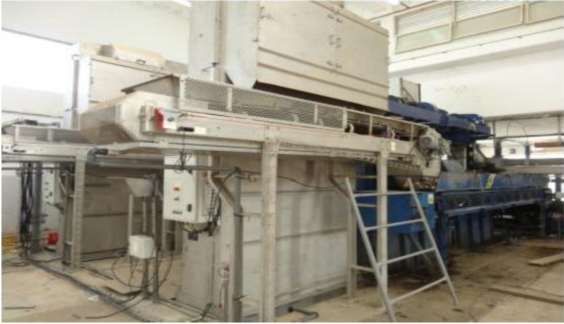
Figure.21 : Dégrilleur fin 412-SD101C et tapis de transport associé
