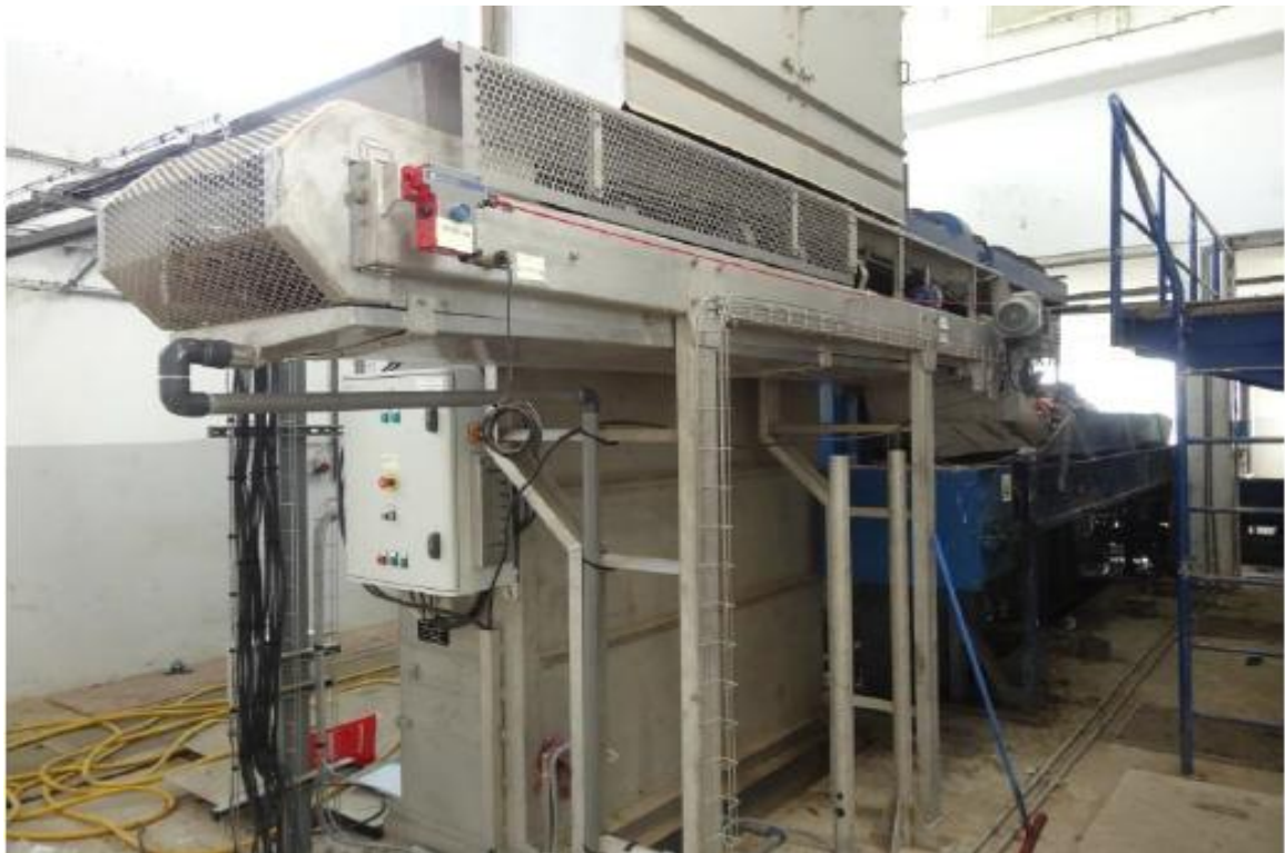
Figure.20 : Dégrilleur grossier 411-SD101C et tapis de transport associé
