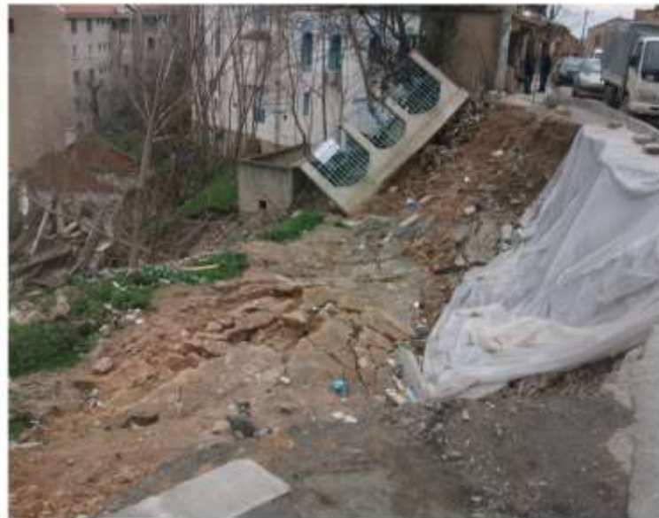
Figure I.3: glissement de terrain (2014 à Ain el hammam).
