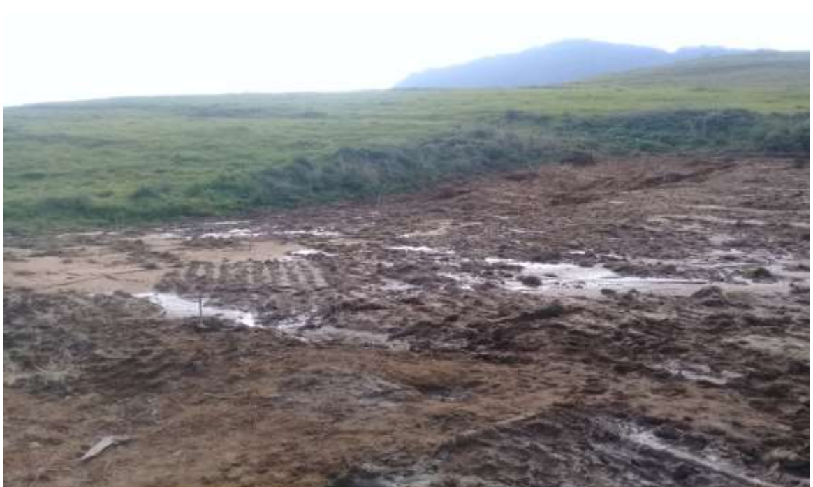
Figure II.4 : Talus de déblai caractérisé par des érosions intenses. Escarpement en tête de talus de déblai [29].
