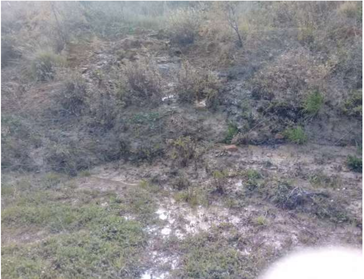
Figure II.3 : Fissures ouvertes au cœur du talus de déblai, laissant les eaux s'infiltrer et développant ainsi des pressions interstitielles nuisible à la stabilité générale [29].
