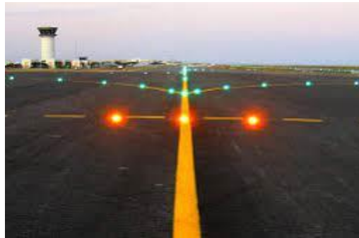
Figure I-17 : Feux d'intersection de voie de circulation [19]
