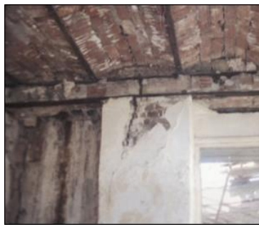
FIG II.20 : Vue sur le plancher à voutains en brique sur poutrelle métallique, des fissures de l'ordre de 5cm dans le mur. Source : revue AMENHIS N°17
