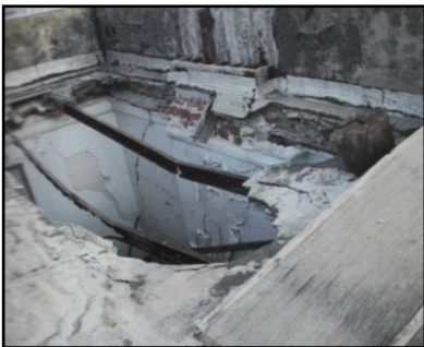
FIG II.20 : Les poutrelles métalliques n'ayant pas été traitées anticorrosion ont rompu sous le poids des ans. Source : revue AMENHIS N°17
