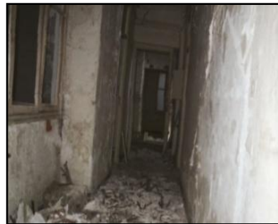
FIG II.20 : Vue sur l'intérieur de l'immeuble, les débris constitué par les plâtres des plafonds et des murs jonchent le sol. Source : revue AMENHIS N°17
