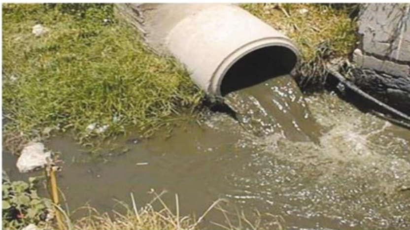
Figure 6 Déversement d'HU dans le réseau d'assainissement
