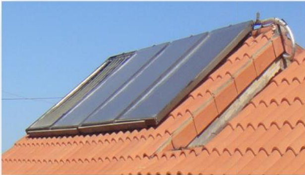
Figure 1-34 capteur intégré en toiture« Soudania- Alger »
