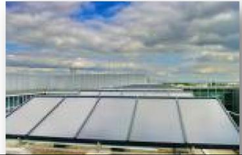
Figure1-29 : Capteurs intégrés en toiture, [19]
