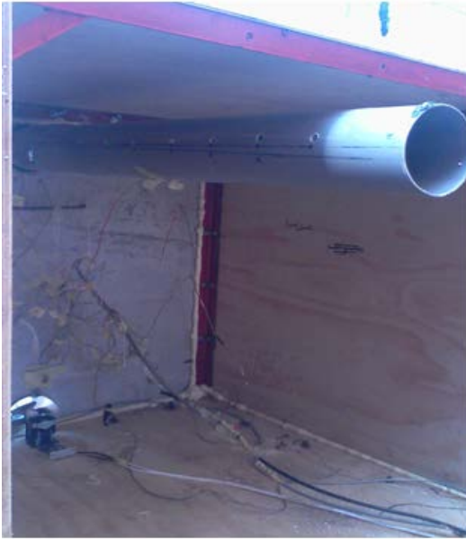
Photo3-9: Canal de distribution de l'air chaude
