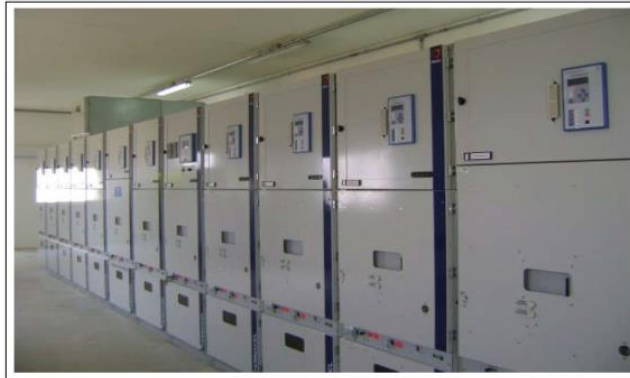
Figure 1.2. un poste HTB/HTA.
