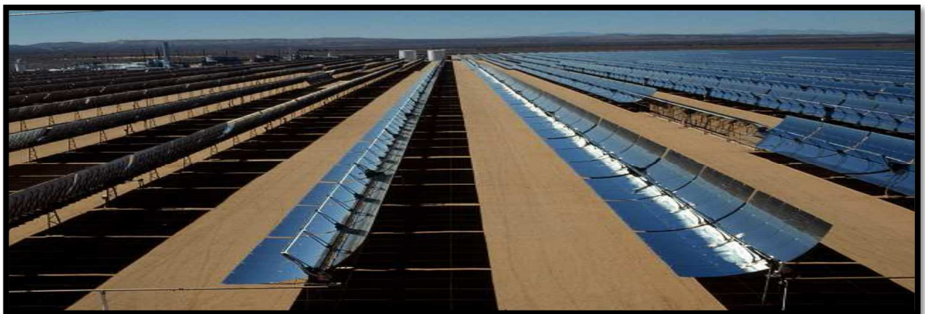
Figure 1.8 : Collecteurs cylindro-paraboliques de la centrale SEGS I à Dagget en Californie
