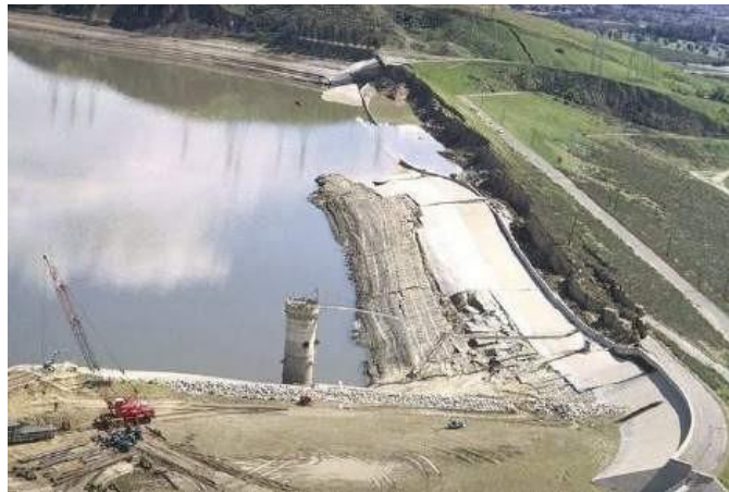
Figure : Glissement du parement amont du barrage de Van Norman lors du séisme de San Fernando (1971).
