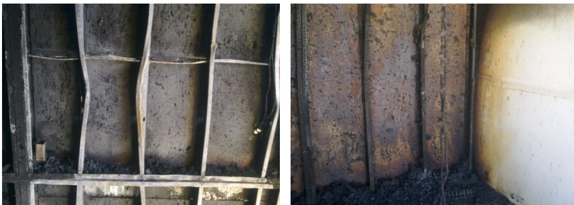
Figure 4 : Panneau CAL de PLF sous incendie réel – NAFTAL, Chlef.
