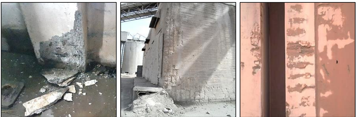
(a) éclatement du béton
