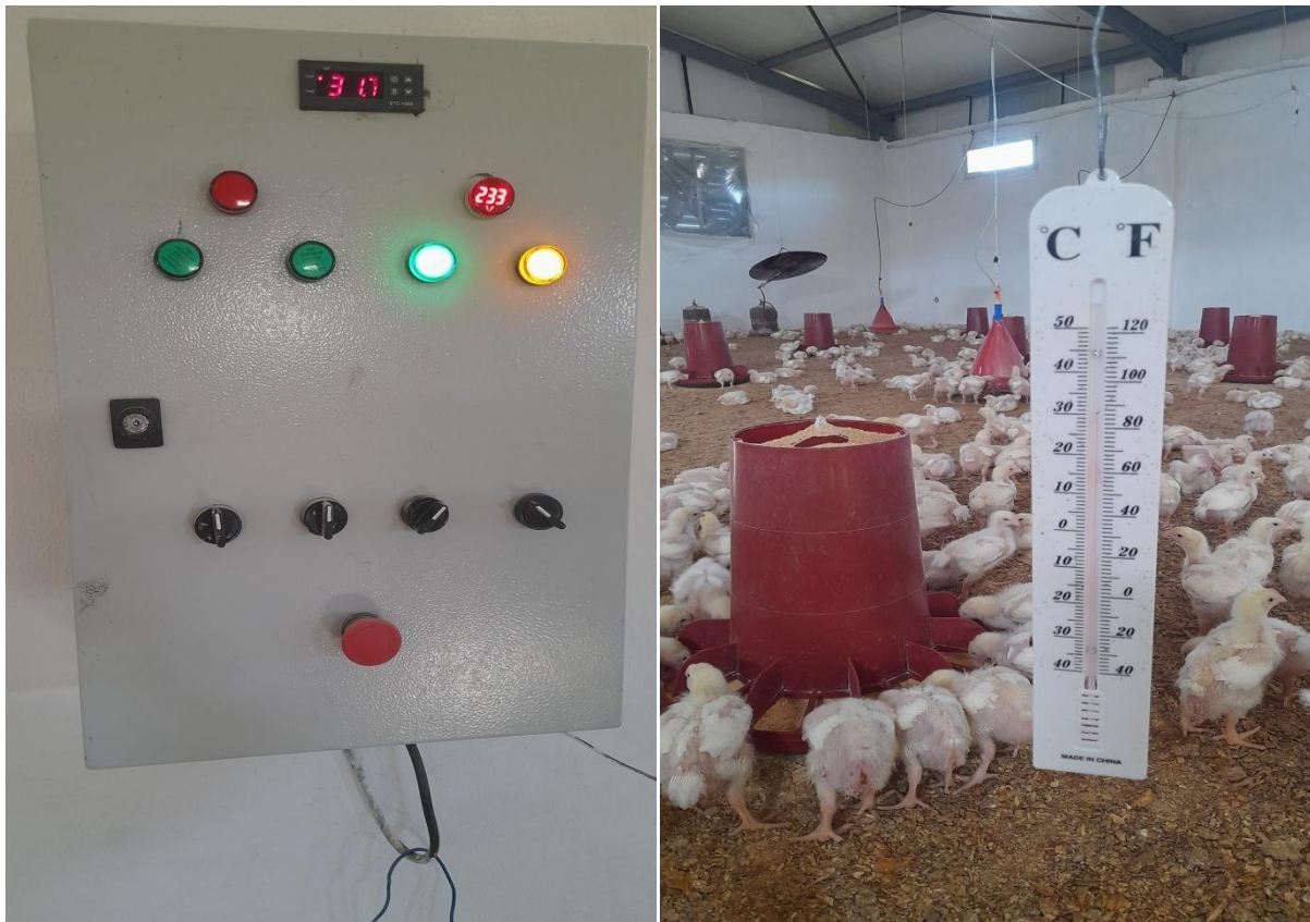
Figure 28 : Thermomètre traditionnel et numérique de l'armoire.
