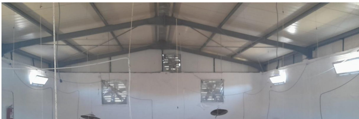
Figure 26 : Systèmes de ventilation (extracteurs et fenêtres).
