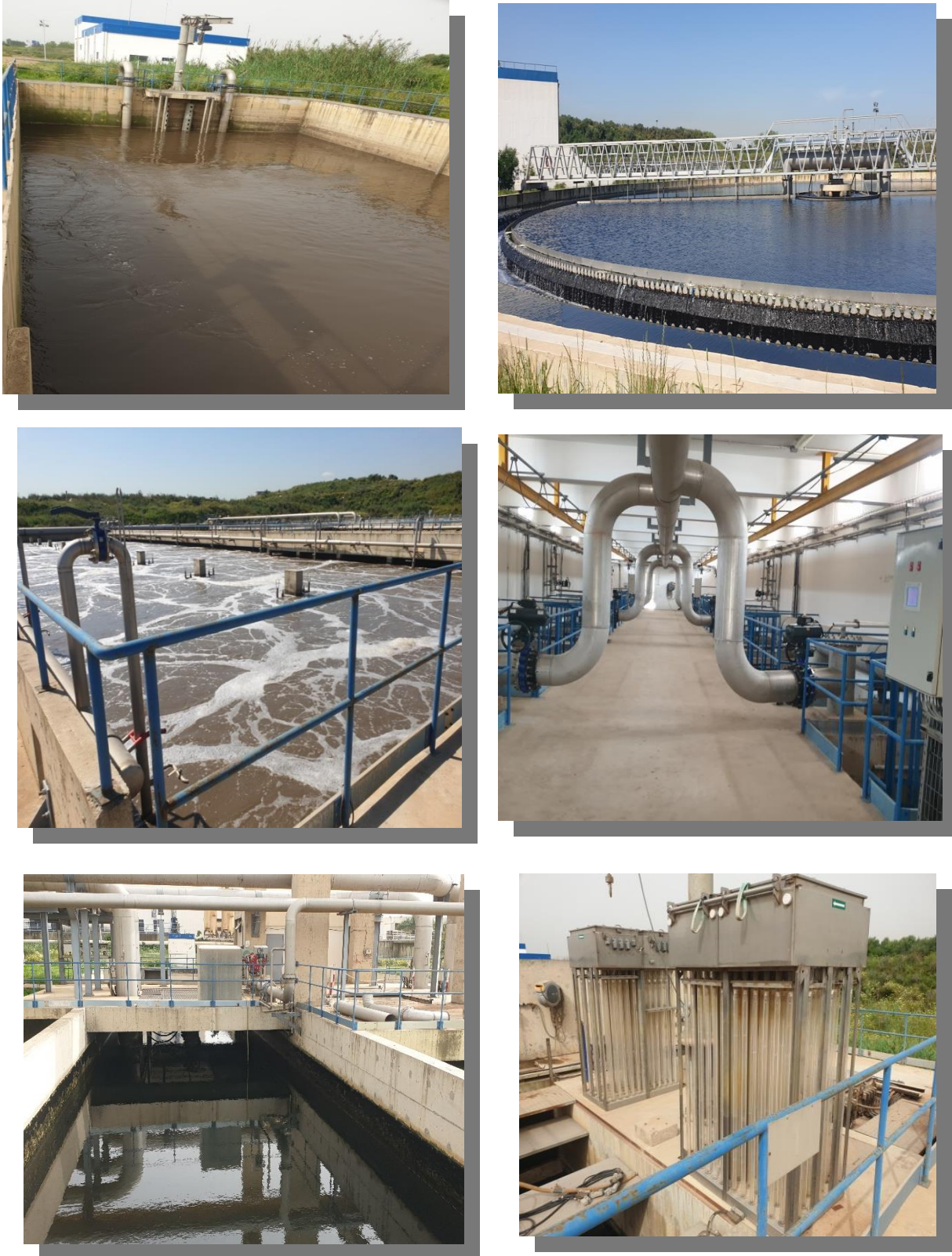
Figure 10 : Les différents ouvrages de la STEP de Baraki.
