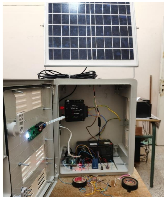
Fig. (IV. 39) : Les capteurs dans la station météo
