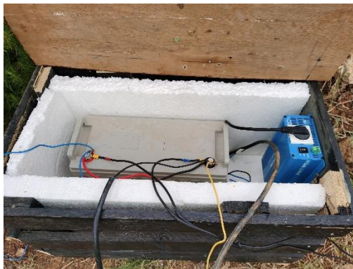
Fig. (IV. 36) : La batterie et l'onduleur
