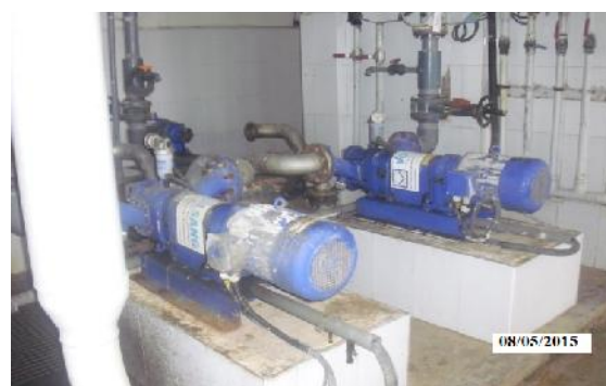
Pompes à boues épaissies.
