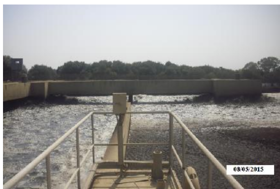
Bassin d'aération de la STEP de Reghaia ( photo originale )
