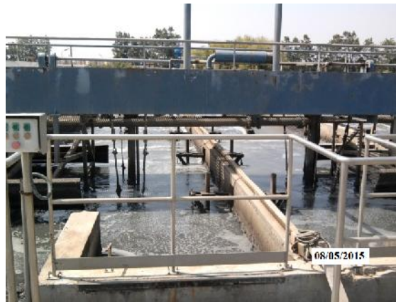
Dessableur dégraisseur de la STEP de Reghaia ( photo originale )
