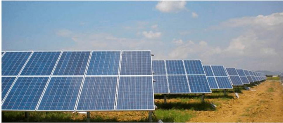
Figure 2-16 : Des Panneaux photovoltaïque. [49]
