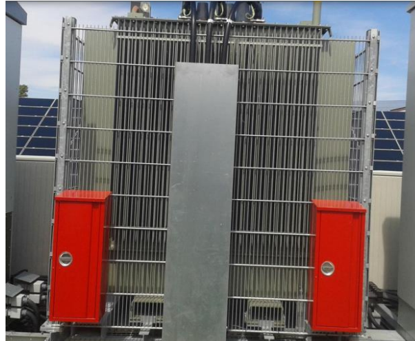
Figure 2.8 : le transformateur de la centrale lebioud sidi cheikh [11].
