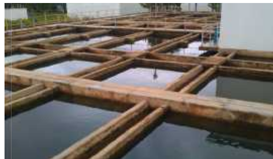
Figure 6 : décanteur lamellaire pulsateur(photo originale, 2015)
