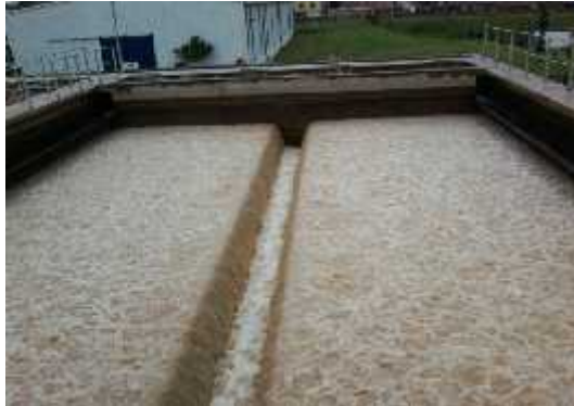
Figure 9 : lavage de filtre(photo originale, 2015)
