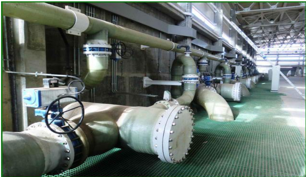
Figure III. 1: Station de dessalement de l'eau de mer de 'FOUKA'
