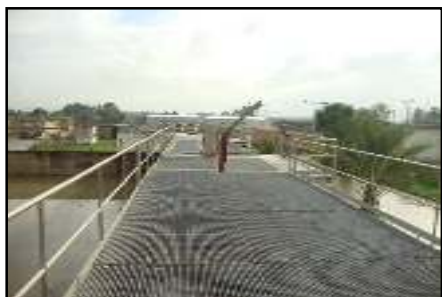
a) Bassin de comptage.
