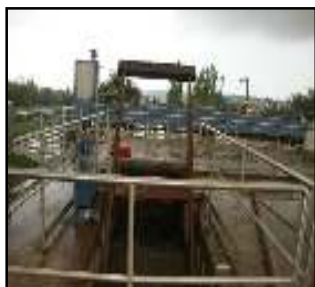
a) Les dégrilleurs automatiques
