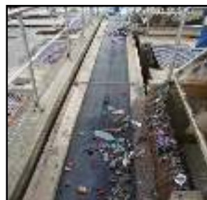
b) Un dégrilleur manuel.
