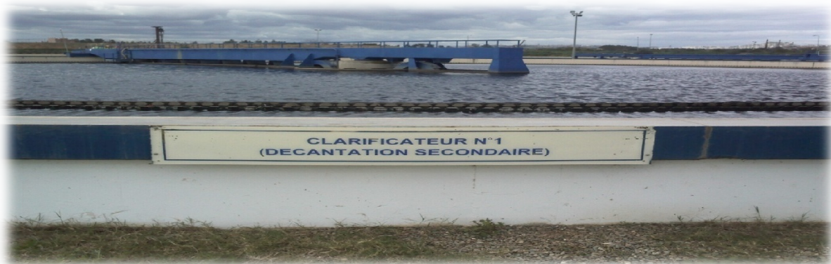
Figure n°10. Décanteur secondaire (photo originale).
