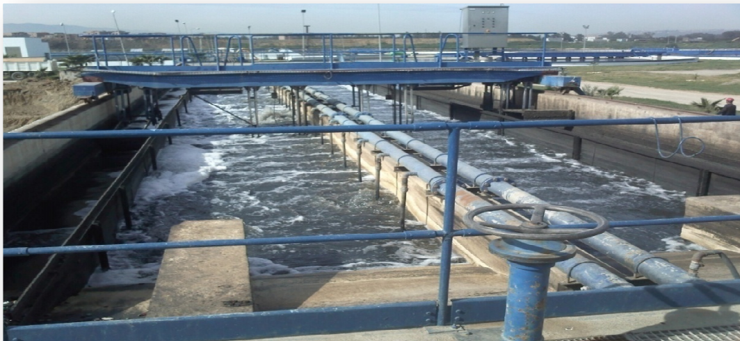
Figure n°8. Bassin dessablage / déshuilage (photo originale).
