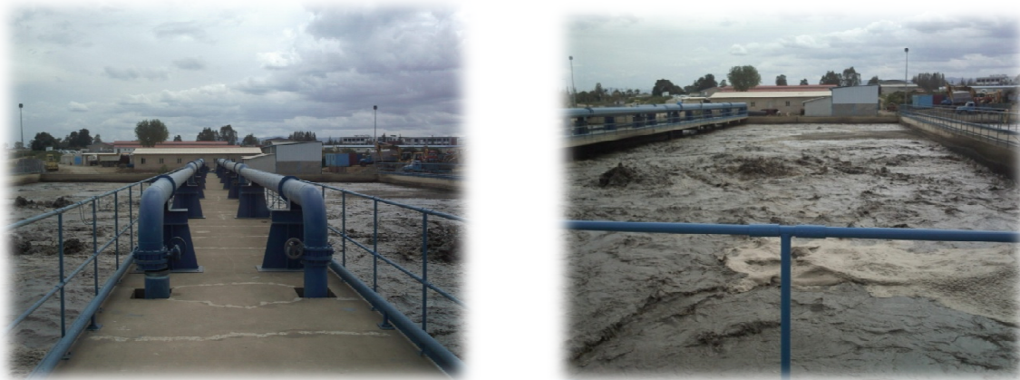
Figure n°9. Bassins d'aération (photos originales).
