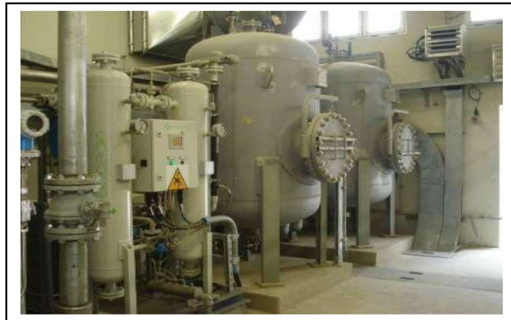
Figure 1.13 Station d'air comprimé.
