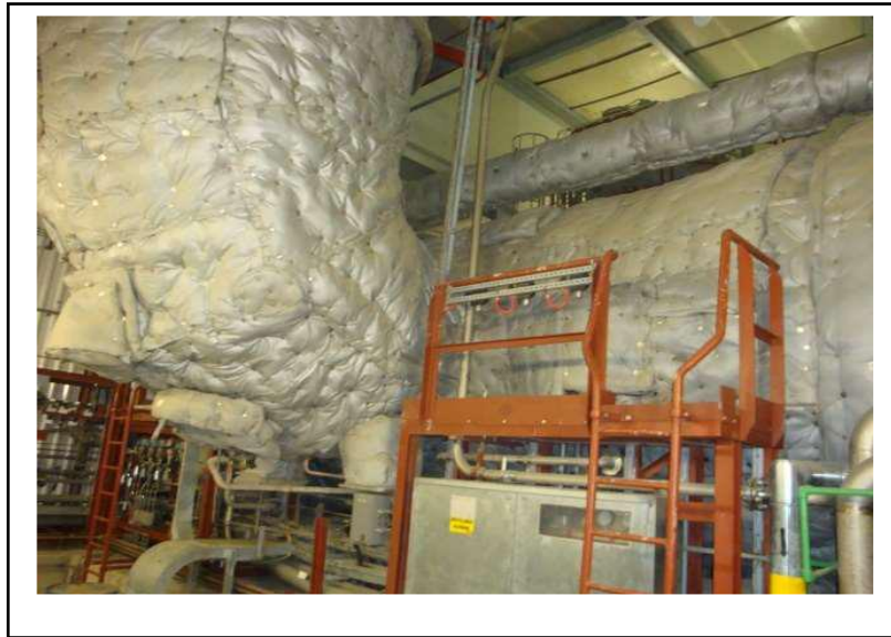
Figure 1.8 Turbine à gaz.
