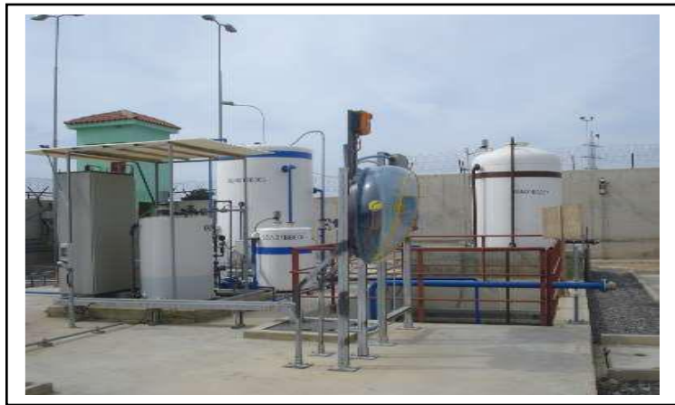
Figure 1.14 Station de traitement de l'eau.
