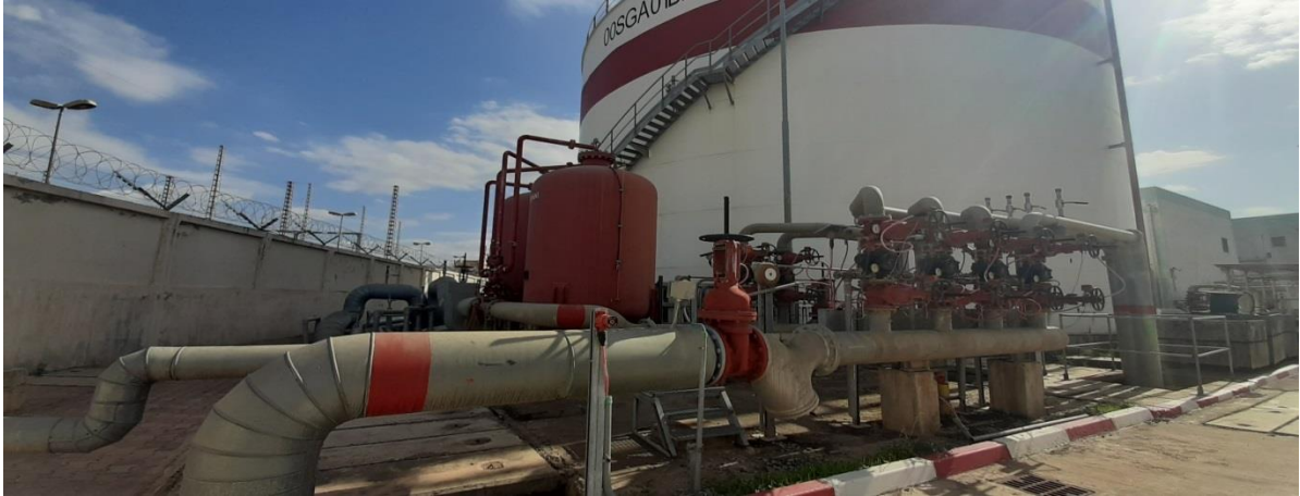
Figure 2.7 Réservoir et vannes de la mousse.
