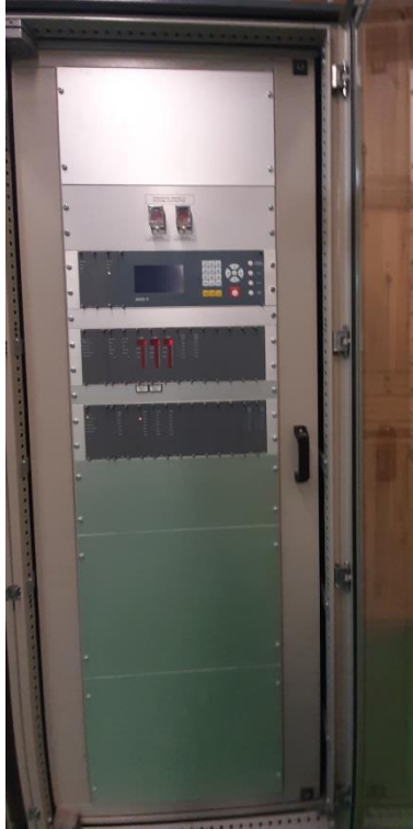
Figure 2.9 armoire de contrôle incendie 11CXU 02.
