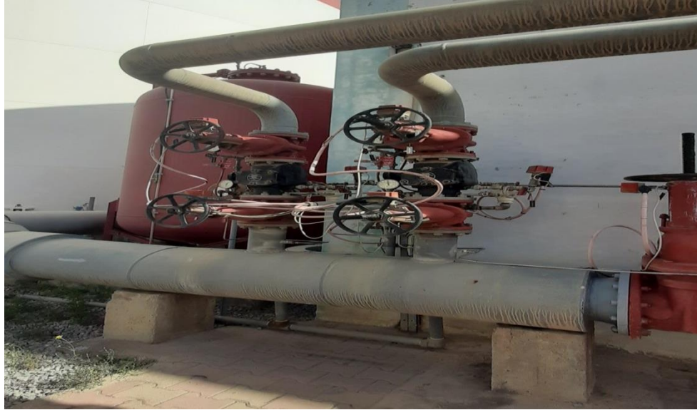
Figure 0.6 réservoir d'eau d'anti-incendie et les vannes de déluge.
