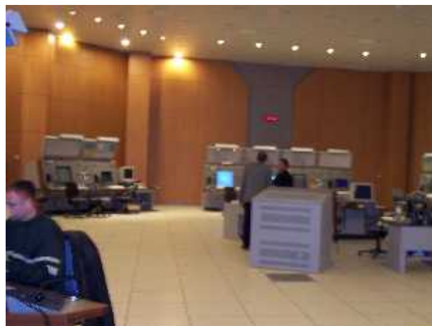
Figure III.1 : Salle de contrôle de CCR d'Alger.
