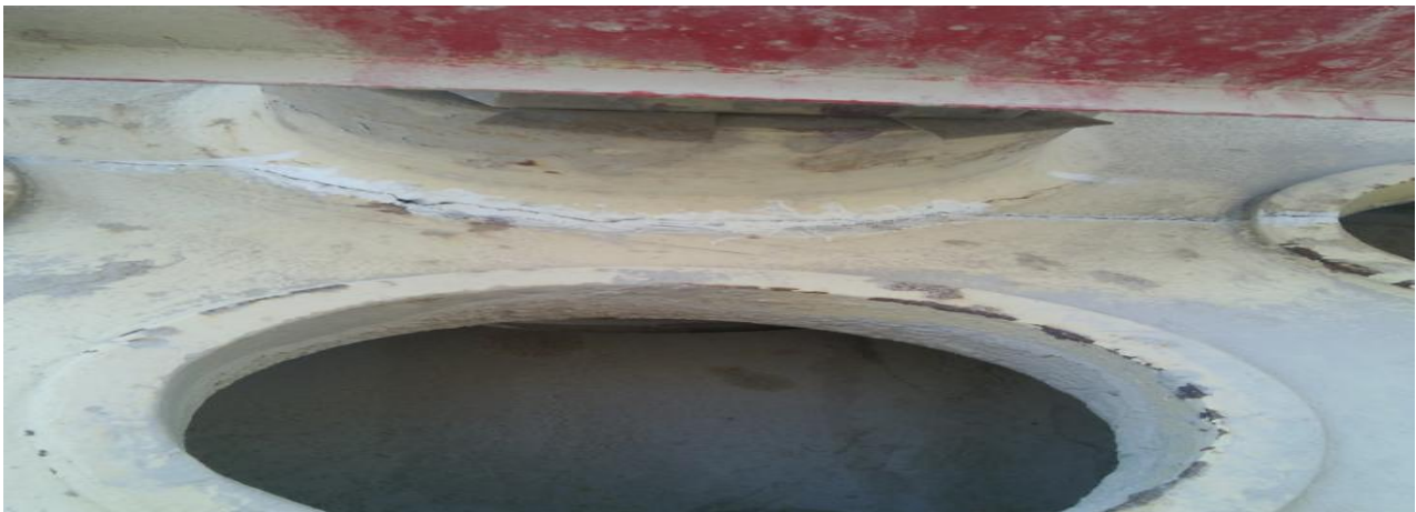
Photo 4.2 Photo Prise sur le volant d'inertie, qui montre la position et la longueur de la fissure et qui est tangente au périmètre du moyeu.
