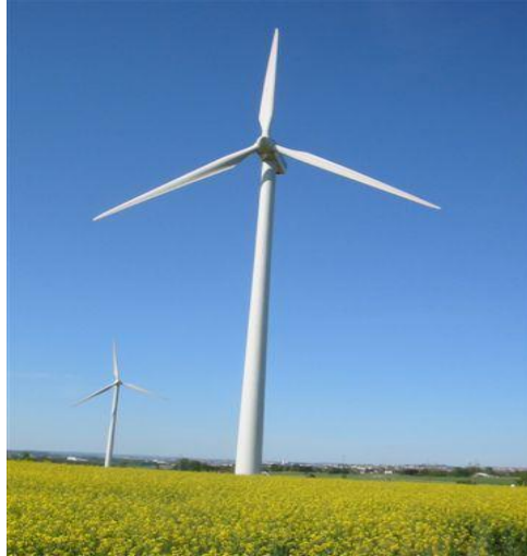
Figure 13 Eoliennes à axe horizontal
