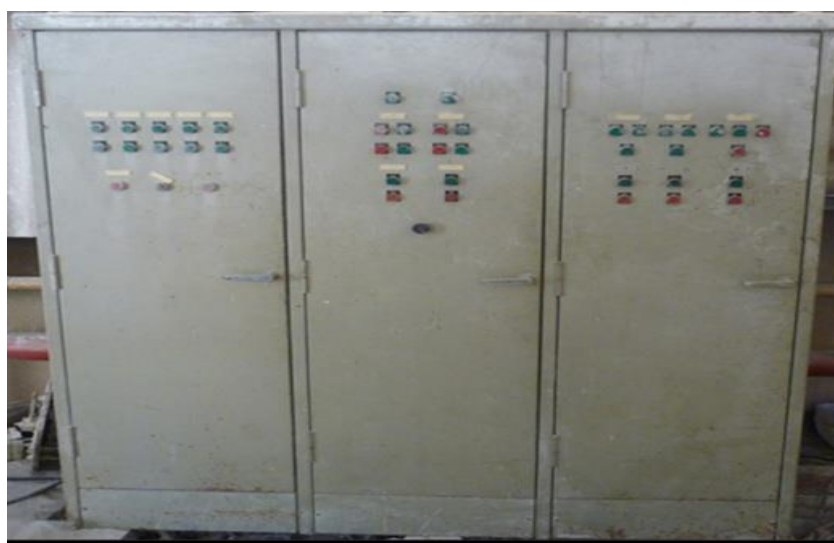
Figure II.5: Armoire électrique partie chargement granulé.
