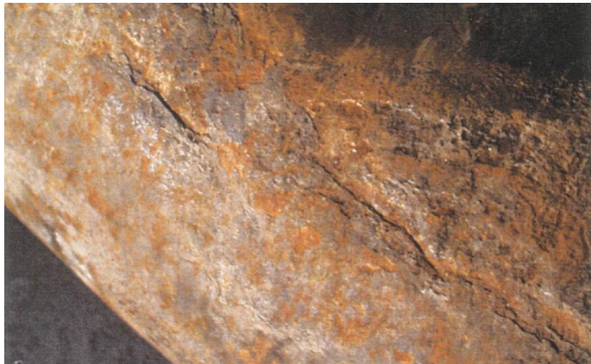
Figure 2.14 : Exemple de la corrosion uniforme
