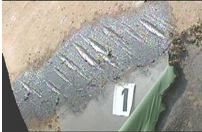
Figure 2.19 : Exemple de pipeline contenant une entaille [26]
