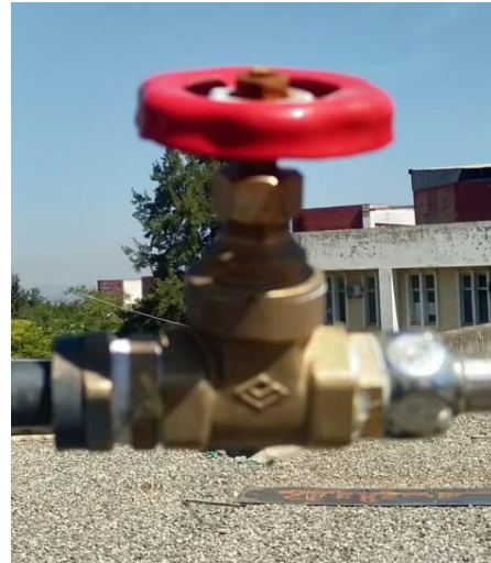
Figure 3.28 Image de la nouvelle vanne de contrôle du débit
