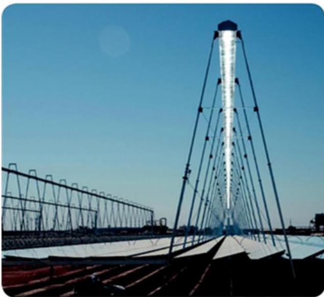
Figure 1.15 Image d'un collecteur a miroir de Fresnel
