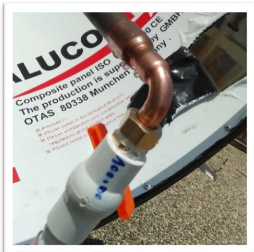
Figure 3.19 vanne d'arrivé d'eau
