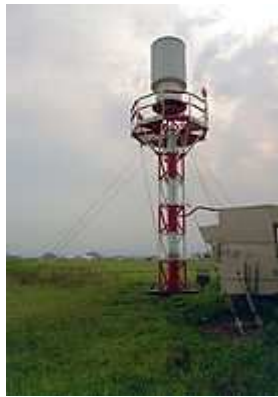
Figure I.9. Une antenne TACAN.
