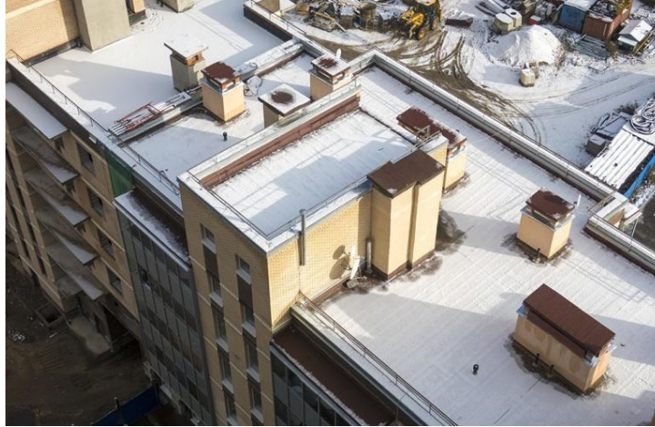
Figure IV. 12 : Effet de Neige sur Toiture
