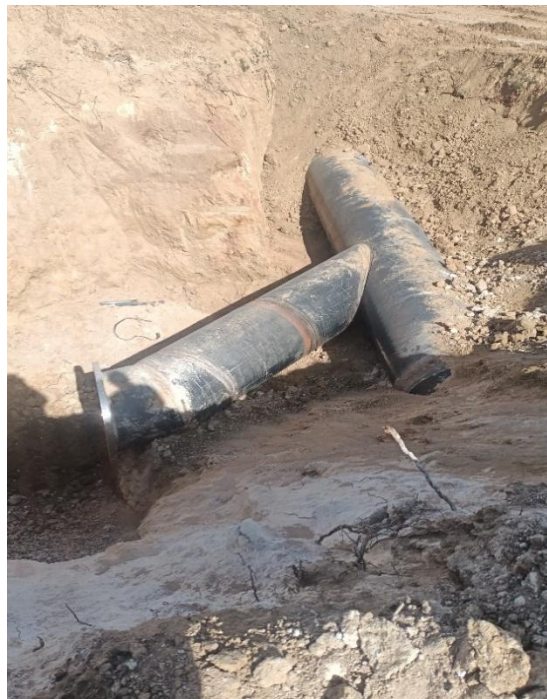
Figure 2.3: Photo réel de la conduite
