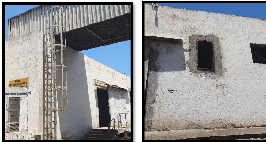
Figure 42: la chambre de compresseur dans la fonderie ALFEL. Source : auteur.
