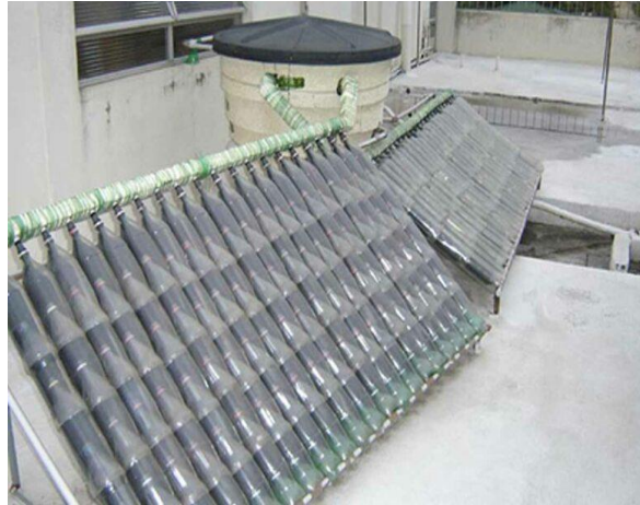
Figure I 4 Un chauffage solaire à base de bouteilles en plastique [41].
