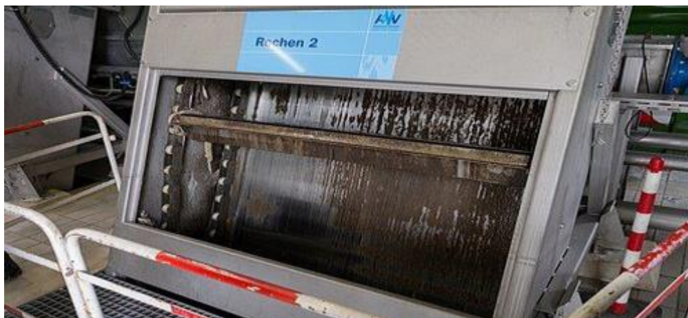
Figure 9: l'opération de dégrillage.
