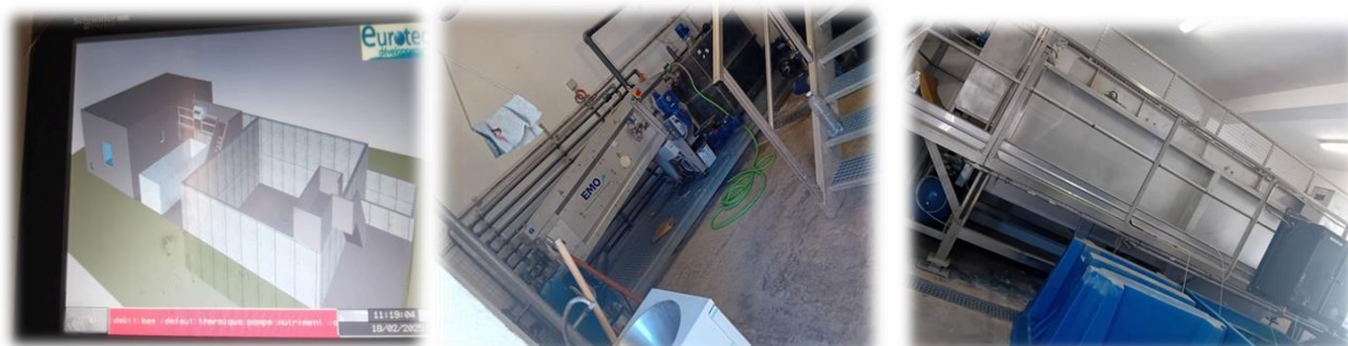
Figure 32 : équipements de salle d'épuration (photos personnelles).
