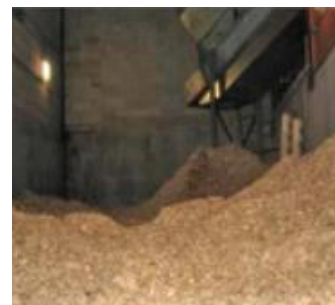
Figure 23: Système de chauffage au bois. Source : association écoquartier
