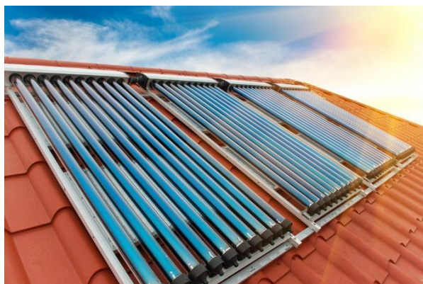
Figure 120: Panneaux solaires thermique
