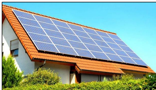
Figure 116: Des panneaux solaires photovoltaïques
