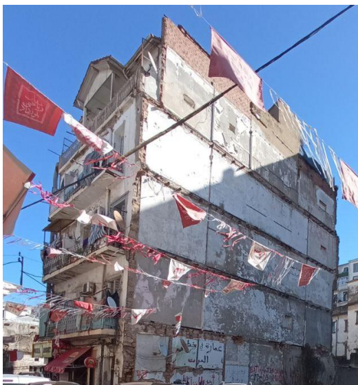
Figure 1. Immeuble vétuste à Alger.
