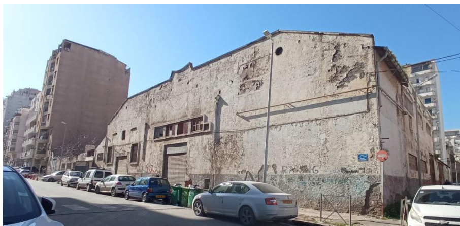
Figure 2. Immeuble vétuste à Alger.
