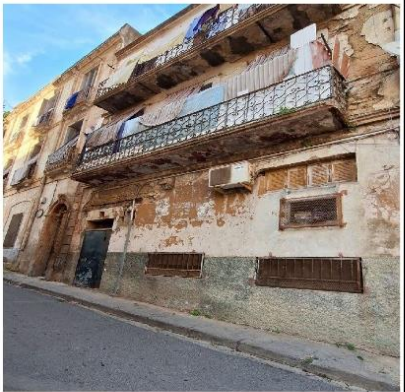
Figure00:immeuble en mauvais état. source:photo prise par les auteurs
