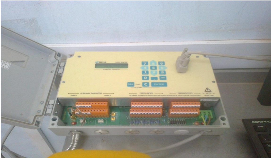
Figure 4.6: Le débitmètre numérique ADM 7407 installé sur le banc expérimental
