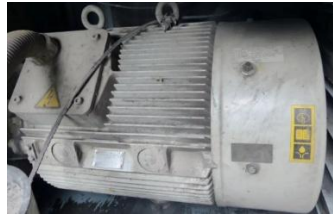
Figure II-9 : Moteur électrique ATLAS COPCO GA75
