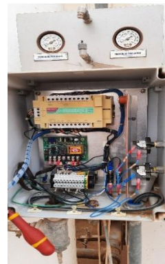
Figure II-20 : Vue intérieure d'armoire
