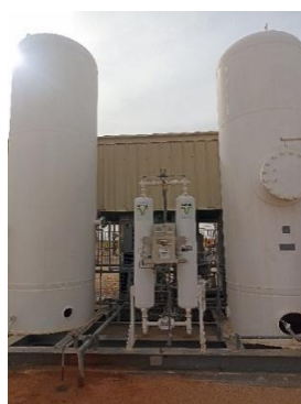
Figure II-17 : Sécheur avec les ballon de réservoir d'air
