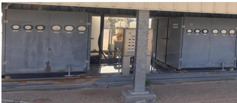
Figure I-4 : Les compresseurs d'air
