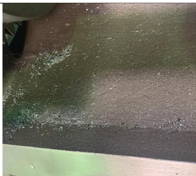
Figure 2. 8 Dépôt de débris métallique2
