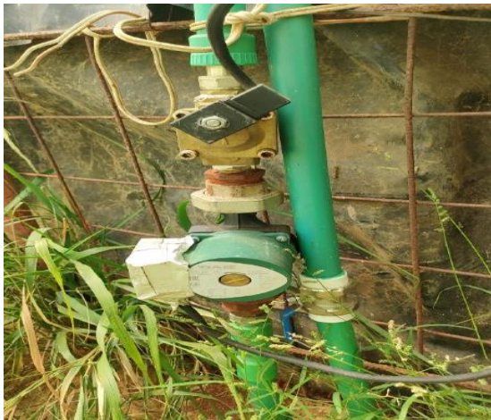
Photo 2 : système chauffage d'eau
