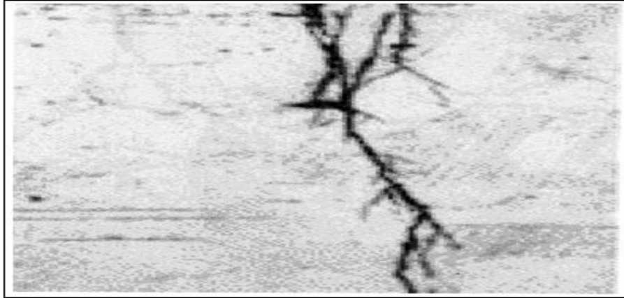
Figure II.1. Corrosion sous contrainte d'un acier inoxydable [19].
